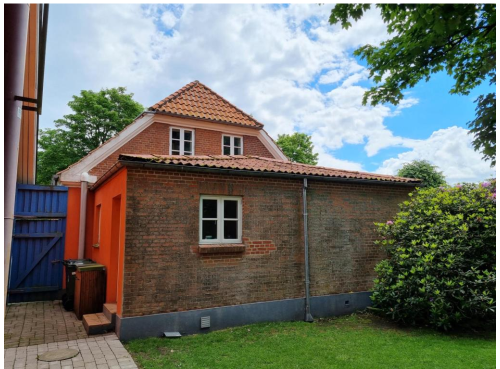
Figur 5-119 Tilbygning på stuehusets vestside, hvor der er adskillige mellemrum mellem tagsten, der potentielt skaber adgang for flagermus ind til tagkonstruktionen.
