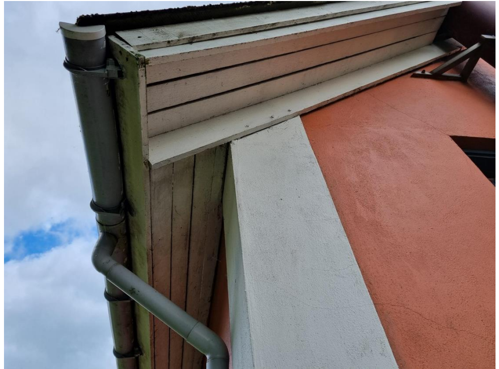
Figur 5-121 Udhængsbrædderne på GR10B er alle i god stand og uden betydelige mellemrum, og der er således ikke adgang ind til tagkonstruktionen ude fra.
