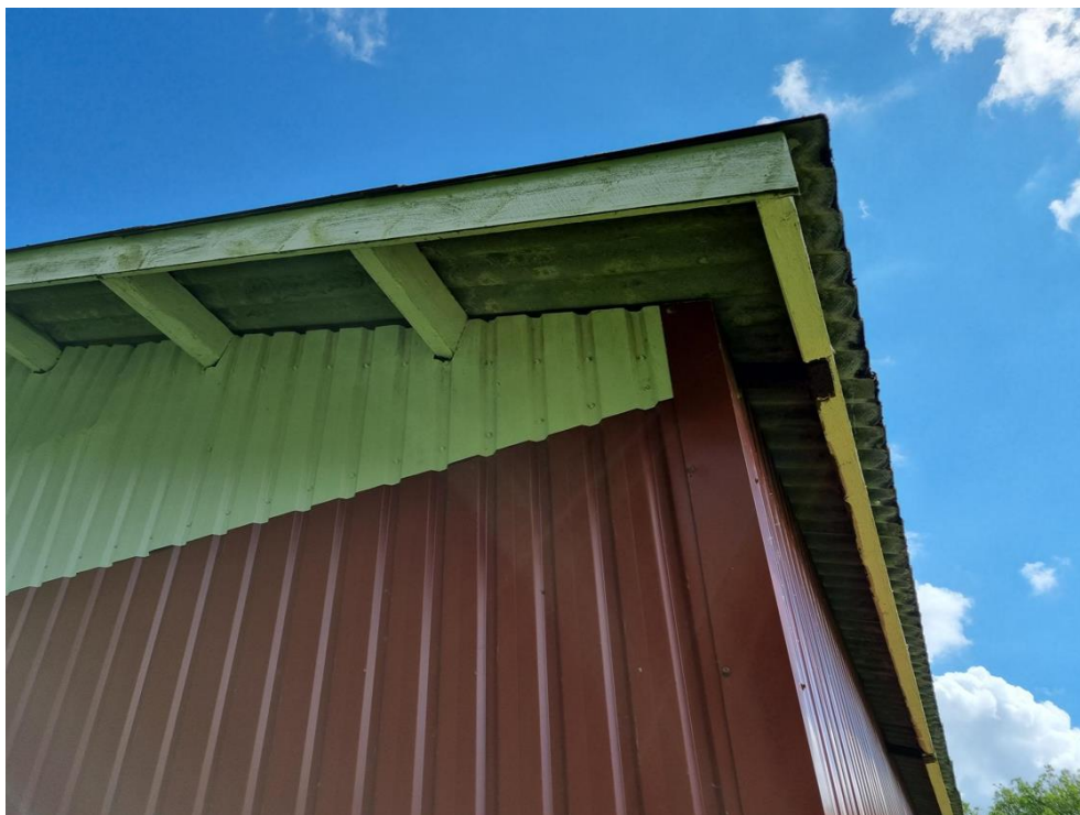
Figur 5-134 Der er hele vejen rundt om GR12B mellemrum imellem væg og tag, hvorved der potentielt er adgang for flagermus ind i bygningen.
