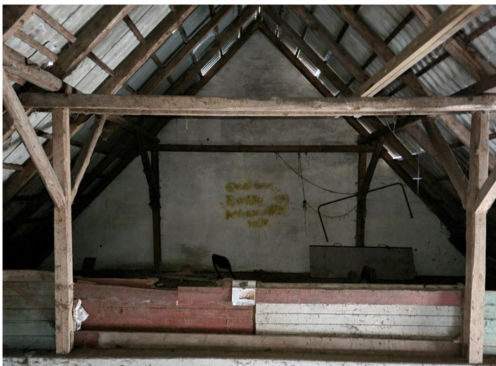
Figur 5-89 Staldbygningens østvendt gavl, der i nuværende situation udgør en væg ind til en tilbygget garage. Det var ikke muligt at komme til denne del, men loftet vurderes her ikke at adskille sig fra den øvrige del.
