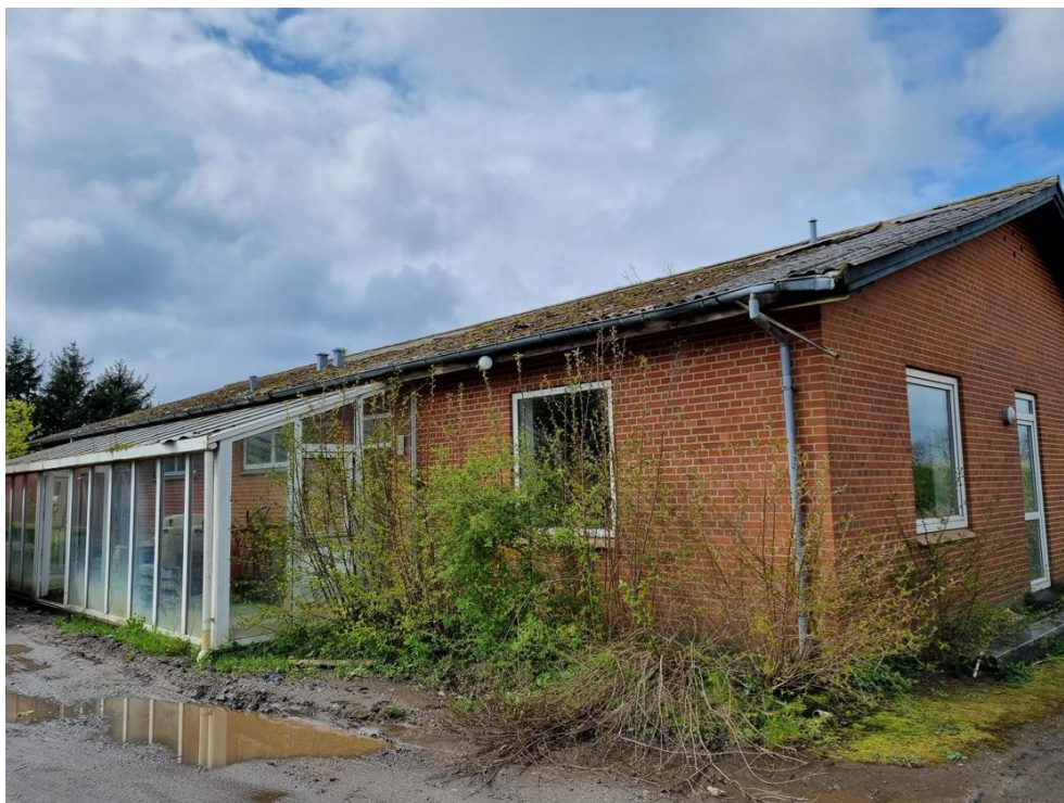
Figur 5-102 GR04B fotograferet imod sydvest. Bygningens tag har adskillige skader og huller.
