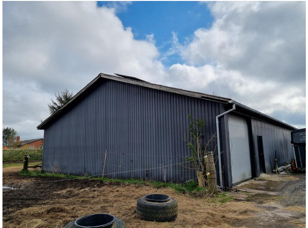
Figur 5-92 Bygning GR02B fotograferet imod nordøst. Langs den vestvendte gavl mangler sternbrædder og en tagplade sidder skævt.
