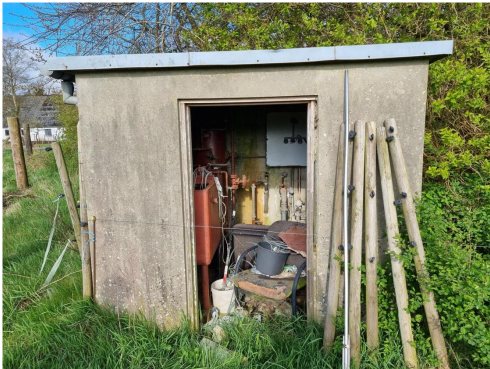
Figur 5-49 Mindre teknikskur ved jordvoldens vestligste ende. Der vurderes at være ingen strukturer, der potentielt egner sig som yngle- eller rastested for flagermus.
