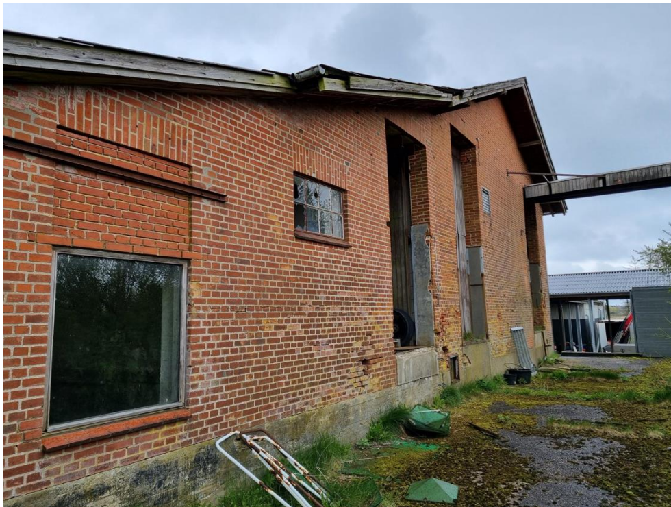
Figur 5-114 Den østlige del af øverste etage af GR08B, hvor både manglende porte og knuste ruder giver adgang ind i bygningen.
