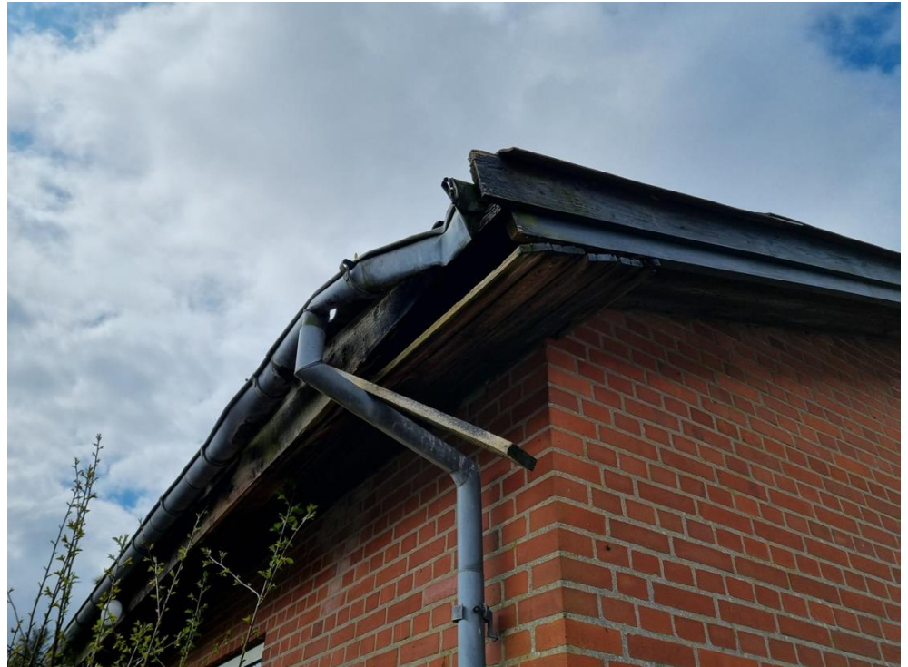
Figur 5-103 Langs bygningen gavle og sider, er flere stern- og udhængsbrædder ødelagte eller manglende.
