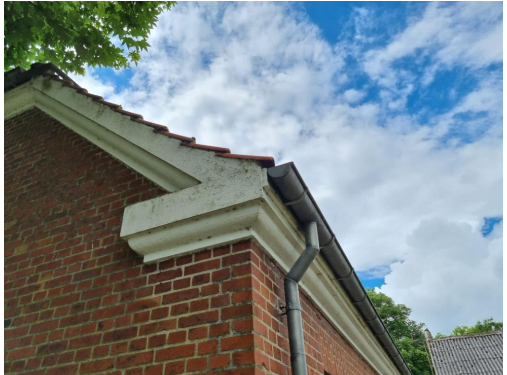
Figur 5-118 Taget på stuehuset sluttet tæt langs husets vægge, men enkelte steder er der mellemrum ind under tagstenene, der potentielt skaber adgang for flagermus in til tagkonstruktionen.
