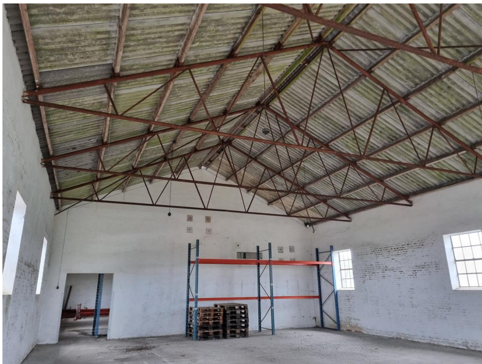
Figur 5-99 Sydlig halvdel af overetagen i GR03B fotograferet imod nordøst, hvor enkelte paller opbevares. På gulvet blev der observeret kviste og æggerester fra ringduereder.
