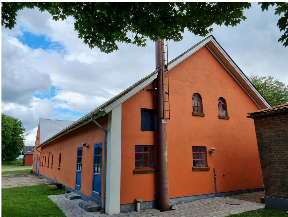
Figur 5-120 GR10B fotograferet imod nordøst. På bygningens sydvendte gavl er vinduerne delvist ødelagt, og der er således adgang ind til bygningens loft.
