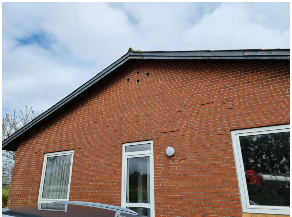
Figur 5-104 Ventilationshuller i sydvendt gavl, hvoraf flere mangler riste.
