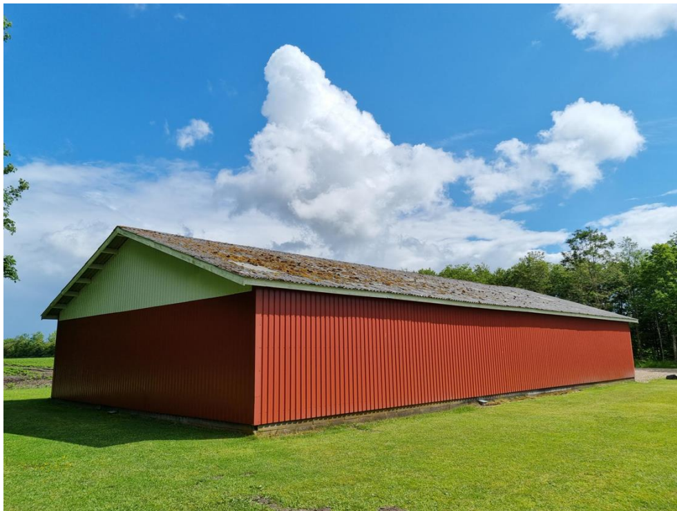
Figur 5-133 GR12B fotograferet imod nordøst. Bygning har gavle vendt direkte imod øst og vest, og fremstår i god stand.
