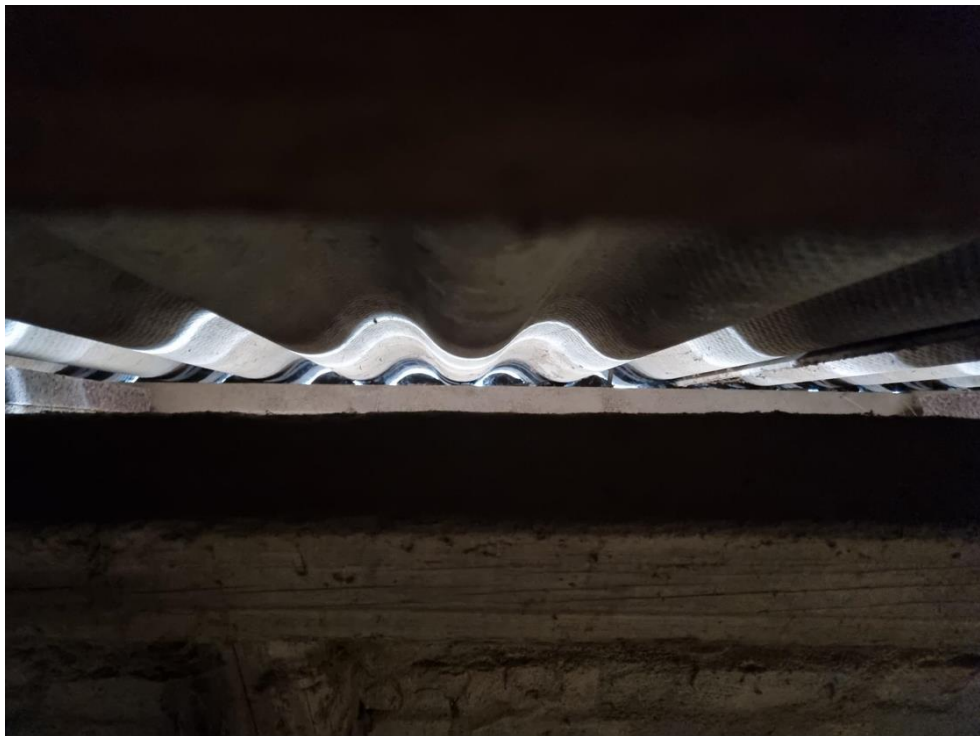
Figur 5-125 GR10B er uden undertag, og langs bygningens øst- og vestside er der mellemrum mellem under tagdækningen, der giver adgang ind til loftet.
