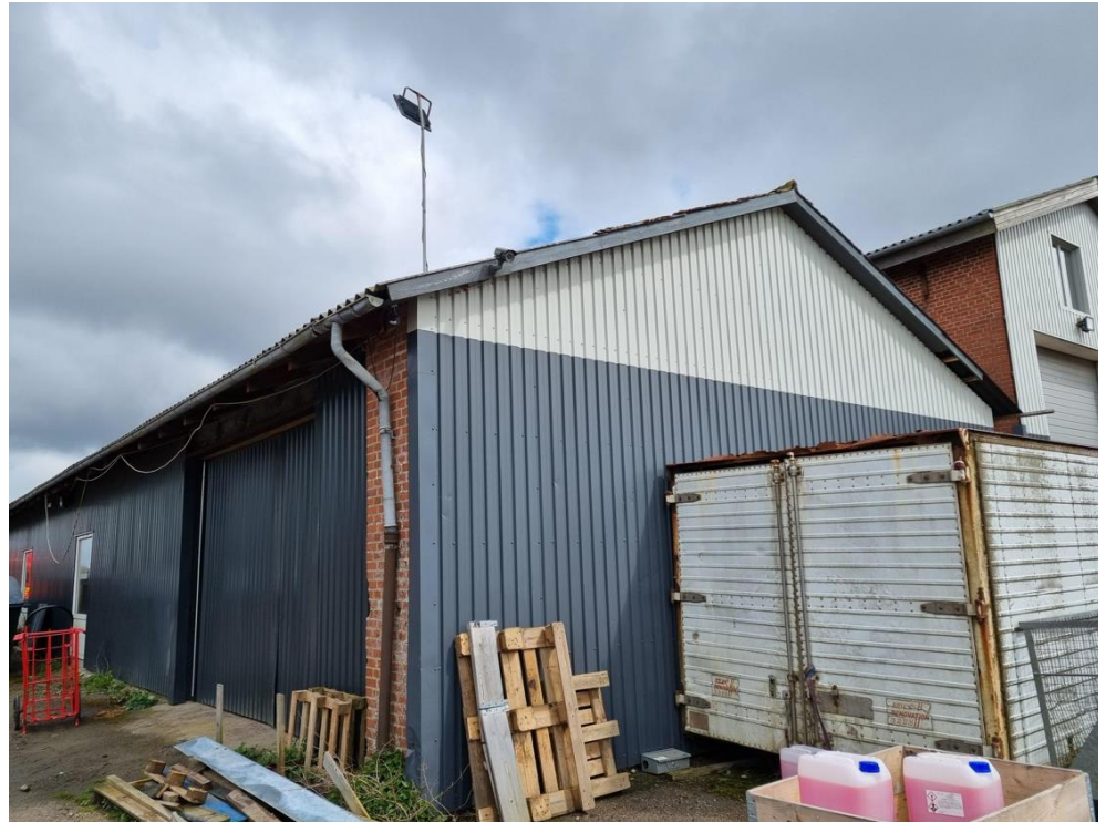
Figur 5-108 GR07B fotograferet imod nordøst. Tagkonstruktionen i bygningens sydøstlige hjørne mangler stern- og udhængsbrædder, og der er således adgang ind til bygningens tagkonstruktion.
