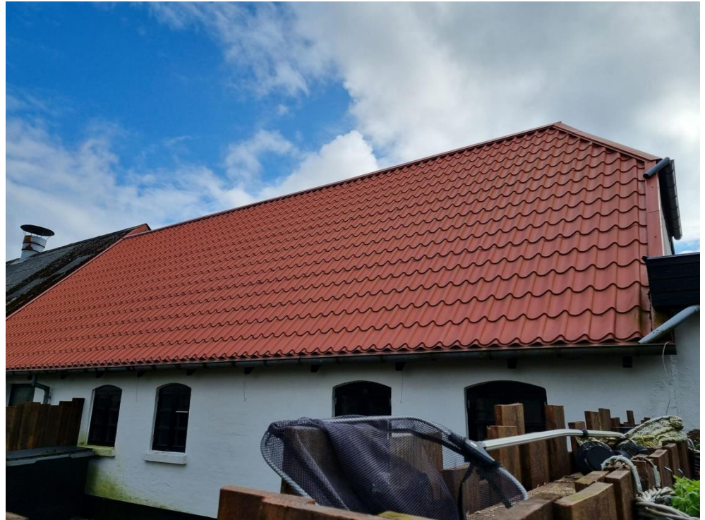
Figur 5-81 Stuehusets vestside fotograferet fra haven. Bygningen og taget fremstår i meget god stand.
