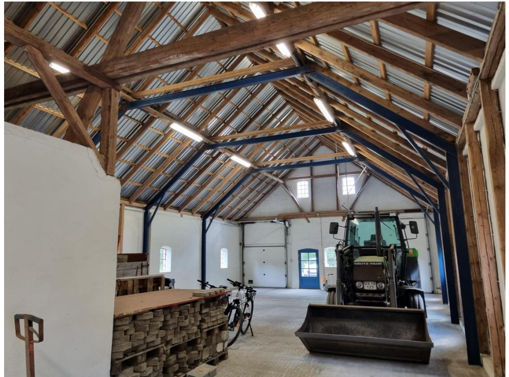
Figur 5-130 Den øvrige del af GR11B fotograferet imod øst. Denne del af bygningen udgøres af ét stort rum, og bruges til opbevaring af materialer og maskiner.
